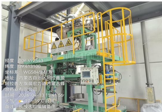
现场装置照片
