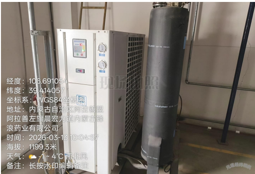
现场装置照片
