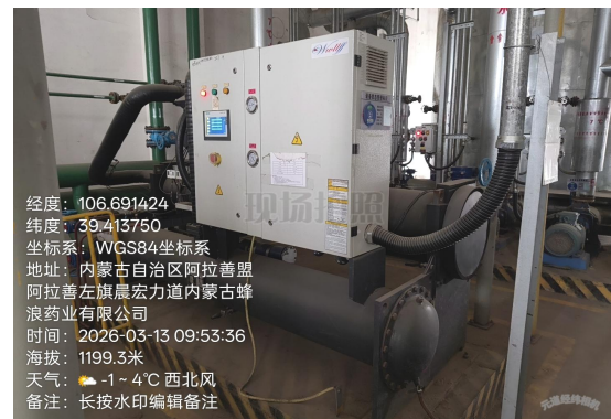
现场装置照片
