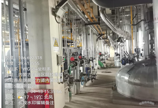
现场装置照片
