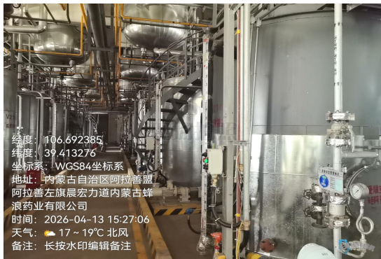
现场装置照片
