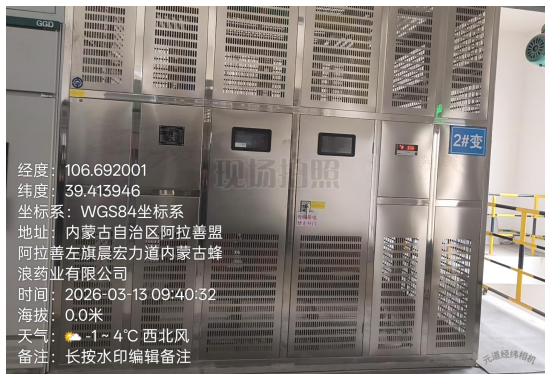
现场装置照片
