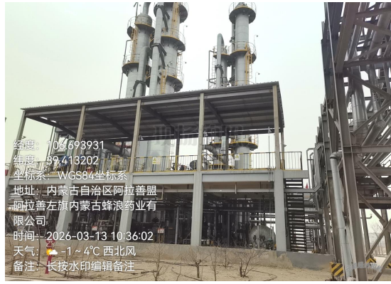
现场装置照片
