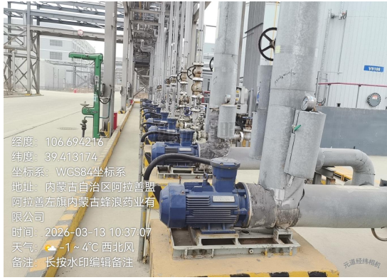
现场装置照片
