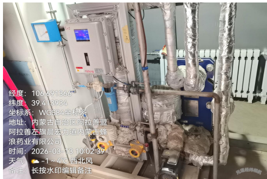
现场装置照片
