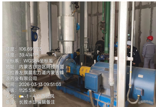
现场装置照片
