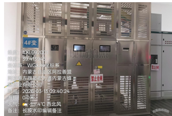
现场装置照片
