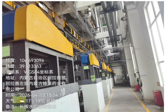
现场装置照片
