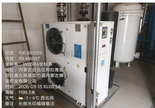
现场装置照片
